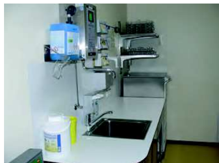
Abb. 1: Aufbereitungsraum, unreiner Bereich. Edelstahlunterschranke mit Desinfektionsmittel-beständige Arbeitsplatte, Desinfektionsmittel-Dosieranlage, Thermodesinfektor (RDG) zur maschinellen Aufbereitung.
